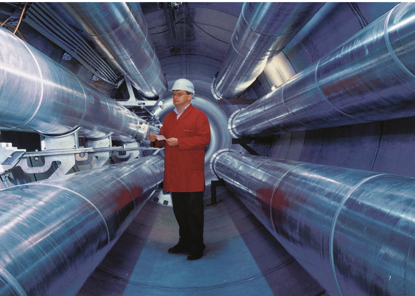
Высоковольтное распределительное устройство с газовой изоляцией
